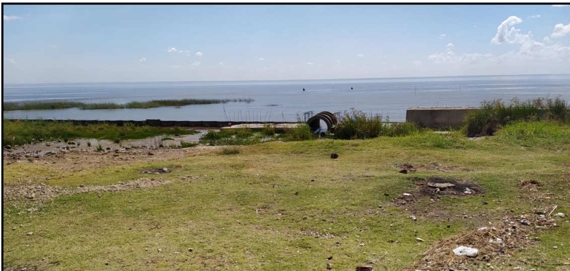
Fotografía 13: Extremo norte del Paseo Costanero – Tablestaca – Muro de defensa incompleto
